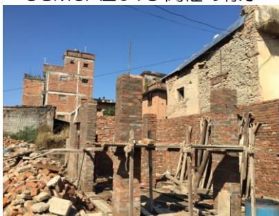
被災現場の様子
